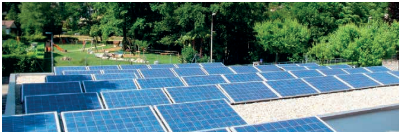
Impianto fotovoltaico presso il cimitero comunale (data di installazione 2011)
