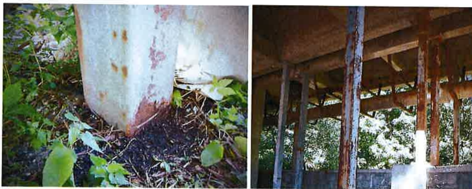
Figura 2 – Sx: base interrata pilastro / Dx: pilastri superficialmente arrugginiti
