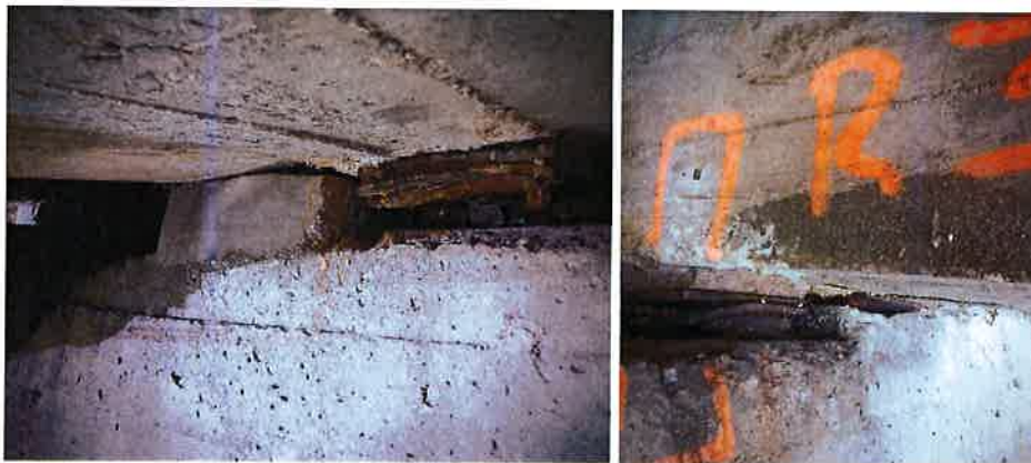
Figura 5 – Sx: Appoggio provvisorio con appoggio originale degradato / Dx: Punto di misura
