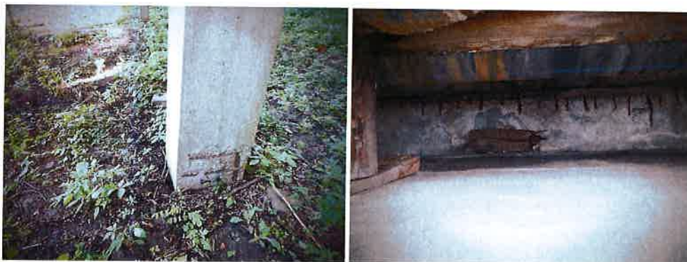
Figura 1 – Sx: armatura corrosa pilastro / Dx: Armatura corrosa trave longitudinale
