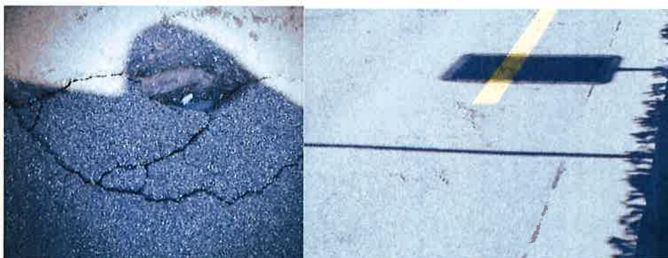
Figura 4 – Sx: Distacchi su giunto / Dx: Fessure pavimentazione
