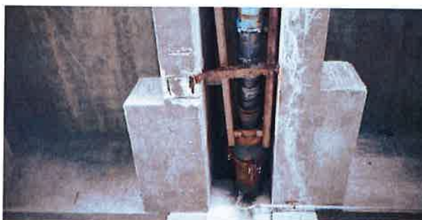
Figura 3 – Traversina di sostegno corrosa
