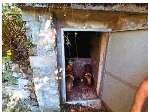
Camera di rottura
